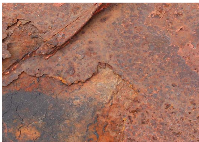
Hloubková koroze plechové krytiny
