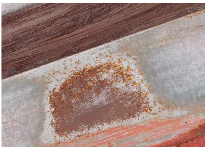
Korozi napadený pozinkovaný plech
